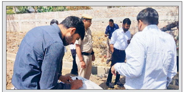
रेवाड़ी। अनाजमंडी से लेकर महाराणा प्रताप चौक तक निर्माणधीन की सामग्री के सैपल एडीसी राहुल मोदी की मौजूदगी में लिए गए। सैपल सील करने के बाद उन्हें जांच के लिए लैब भेजा गया है। इस समय अनाजमंडी से महाराणा प्रताप चौक तक नाले का निर्माण कराया जा रहा है। इसमें विकारियों को करोड़ों रुपये की राशि खर्च की जा रही है, जिसमें दीवार निर्माण भी शामिल है। इन कार्यों पर लगभग 250 करोड़ रुपये की राशि खर्च की जा रही है। हाल ही में आई बिशप के कारण निर्माणधीन नाले का एक हिस्सा विरग गया था, जिससे निर्माण सामग्री की गुणवत्ता को लेकर सवाल उठने लगे थे।
